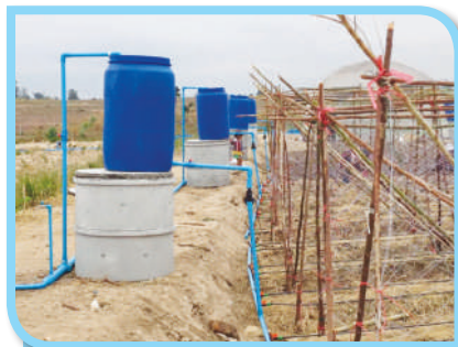
รูปที่ 2 ระบบสวนครัวน้ำหยดที่ติดตั้งภายในศูนย์เรียนรู้ จ. อุทัยธานี
