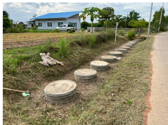
ฉ) ดูแลสภาพแวดล้อมบริเวณรอบ ๆ ระบบ
